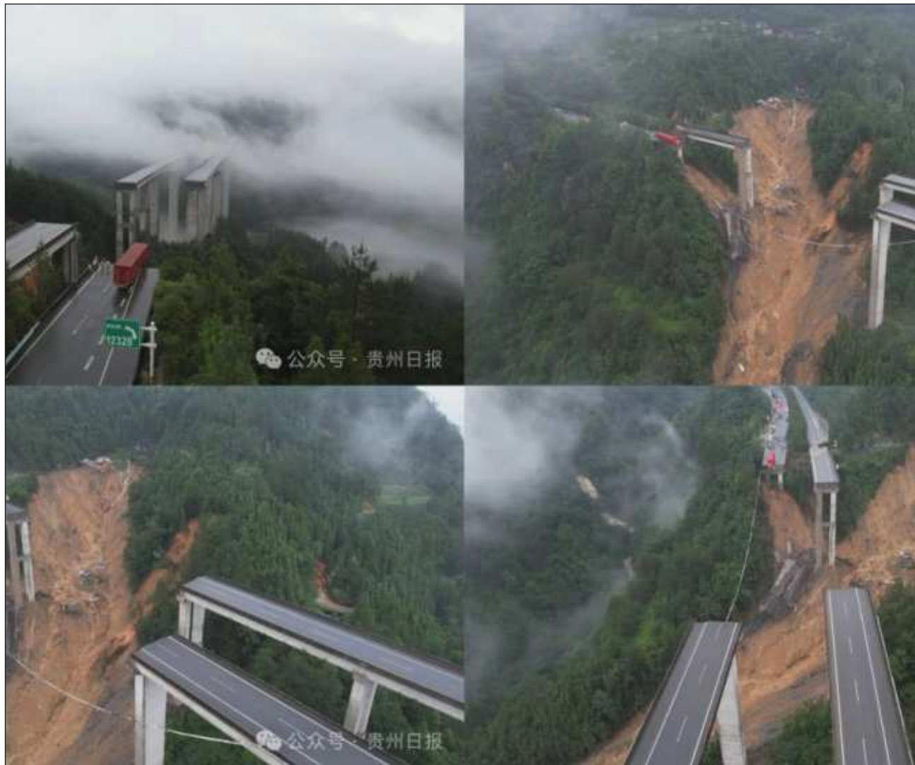
▲ Un deslizamiento de tierra provocado por las fuertes lluvias causó el derrumbe de los pilares del viaducto de la autopista de alta velocidad Xiazong; el conductor de un camión logró detener el vehículo a tiempo, colgado de su remolque al borde del precipicio. Foto Sputnik
