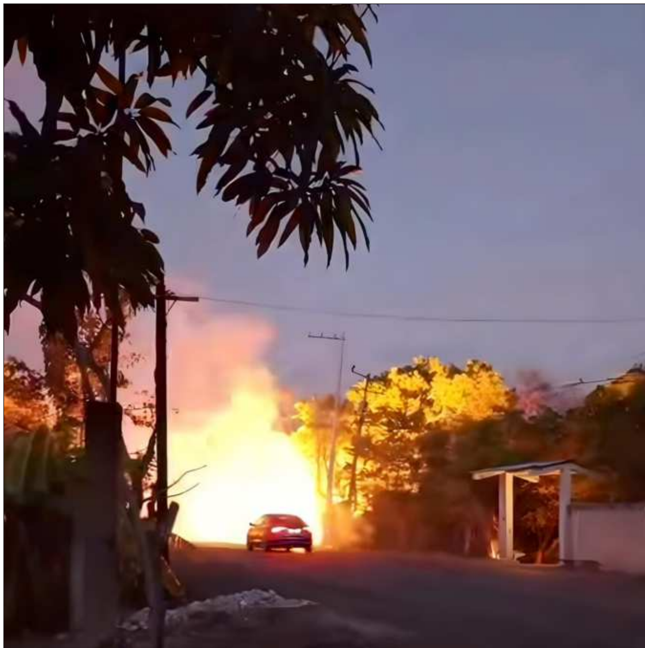
▲ El fuego en un transformador provocó la falta del suministro de luz por cuatro horas el lunes. Foto captura de pantalla
