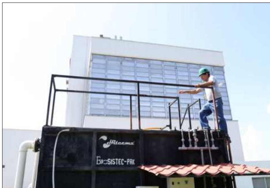
▲ Planta de alimentos balanceados de empresa porcícola recibe certificación ISO 14001:2015 tras cumplir con norma voluntaria mediante eficiente Sistema de Gestión Ambiental. Foto Kekén
