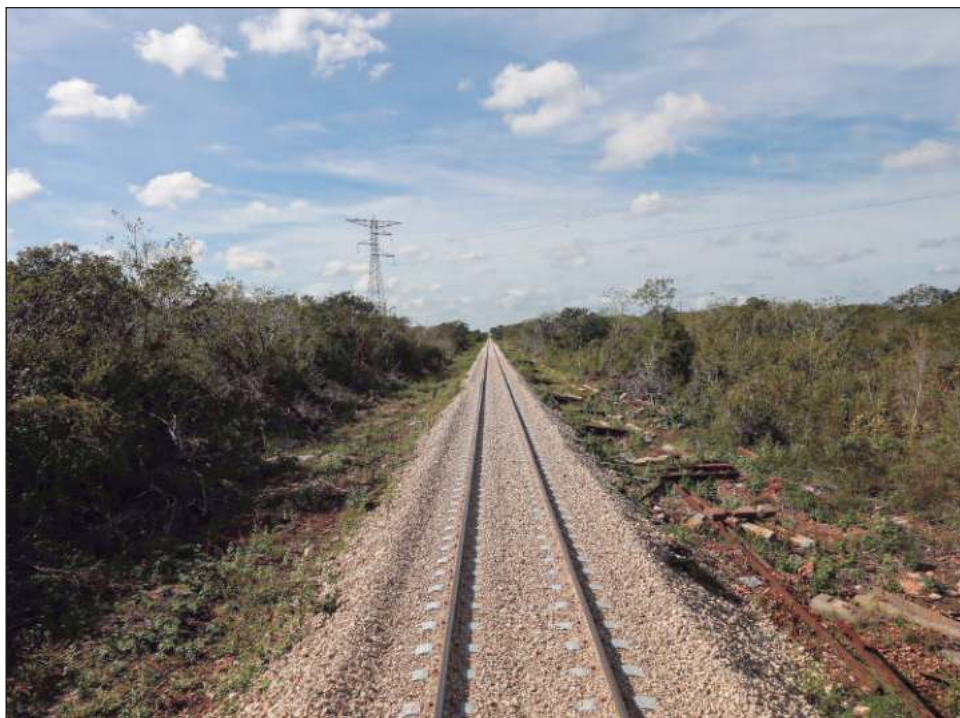
▲ El presidente López Obrador señaló que entre las principales obras están el Tren Maya, el Transístmico, el tren suburbano México-Toluca y dos nuevas rutas en Jalisco. Foto Enrique Osorno
