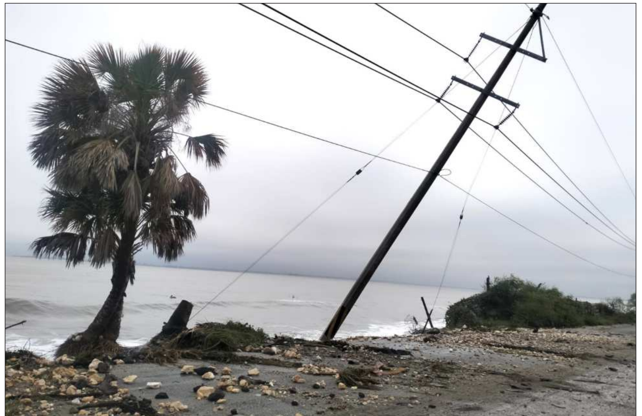
▲ Las autoridades han emitido la alerta a los conductores de vehículos de carga, para que tomen sus precauciones para evitar accidentes. La Dirección de Protección Civil dio a conocer que con el pleamar no se tuvo registro de ingreso de agua a los predios. Foto LJM
