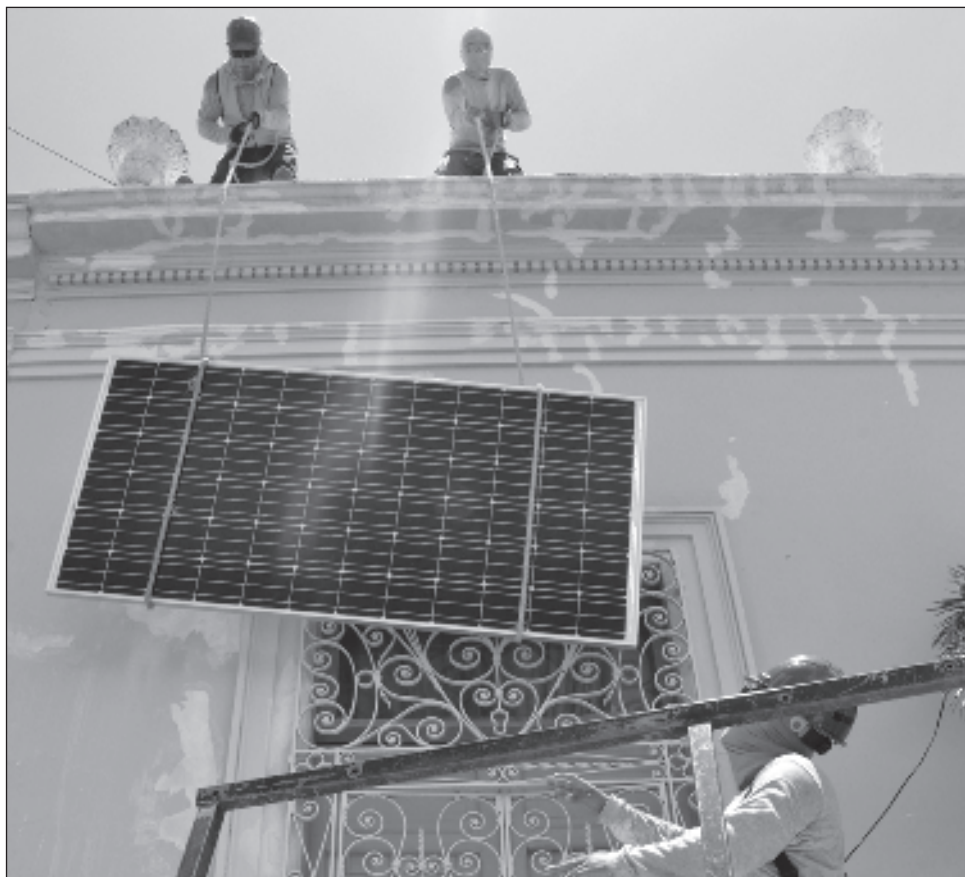
▲ Claudia Sheinbaum anunció que la CFE y la Sener presentarán un programa en Mexicali, que consiste en instalar paneles solares en viviendas. Foto Rodrigo Díaz
