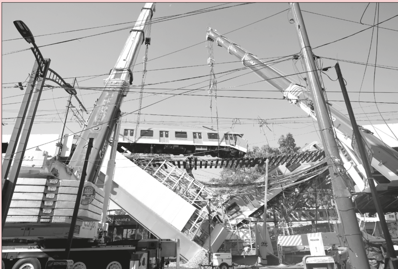
▲ El colapso de la línea 12 del Metro dejó 26 muertes en mayo de este año. De acuerdo con el peritaje, el accidente ocurrió por "deficiencias" en la construcción y el diseño. Foto Luis Castillo
