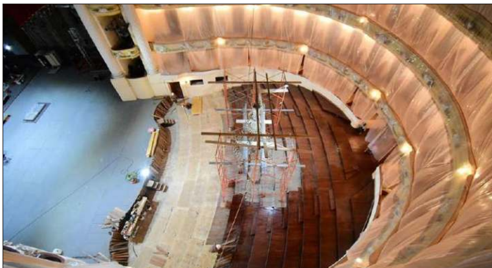
▲ Los trabajos de restauración han sido complejos y requieren de mucho cuidado. Foto Sedeculta
