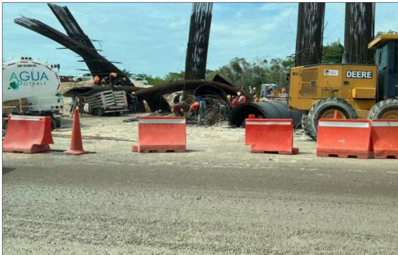
▲ Las varillas que conformaban los castillos fueron dobladas por el viento; uno de ellos cayó sobre una camioneta. Foto LJM
