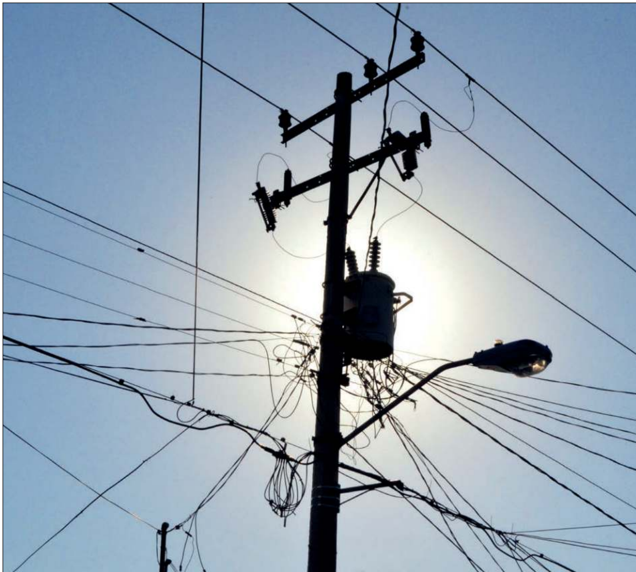
▲ Las constantes fallas en el servicio eléctrico de Carmen han provocado que vecinos inconformes bloqueen calles y avenidas de la isla, generando conflictos viales e inconformidad de los terceros afectados. Foto Rodrigo Díaz
