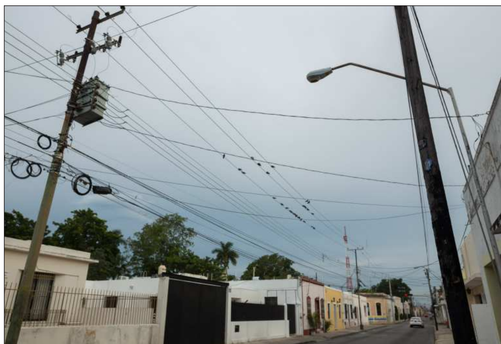
▲ Lo urgente es corregir el rumbo de lo que se ha querido llamar desarrollo, que pretende un crecimiento urbano acelerado para el cual no se tiene la infraestructura de servicios. Foto Enrique Osorno / Archivo
