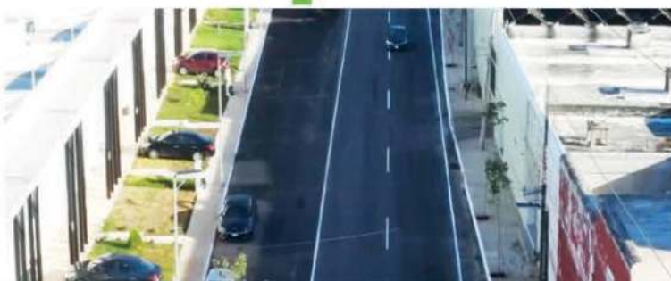
Construcción y repavimentación de más de 3.8 kilómetros de calles que abarcan la 46, 43 y 55. Adicionalmente se realizará la construcción de banquetas y guarniciones, señalética, sistema de iluminación y pozos pluviales.
