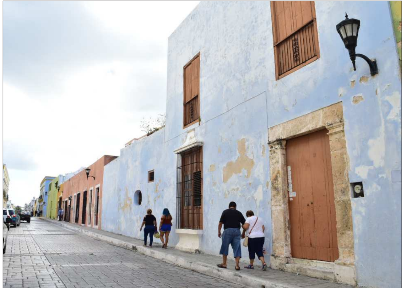
▲ Cuando Protección Civil municipal detecta alguna vivienda en riesgo, se realizan recorridos y se determinan las medidas que pueden aplicarse, aunque muchas de estas casas están deshabitadas y son particulares. Foto Lucio Blanco
