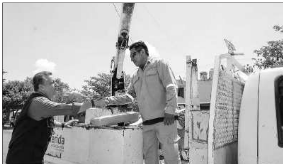
▲ El ayuntamiento refuerza el programa de bacheo y mantenimiento de las calles a fin de evitar en lo posible las afectaciones viales en esta temporada de lluvias. Foto ayuntamiento de Mérida
