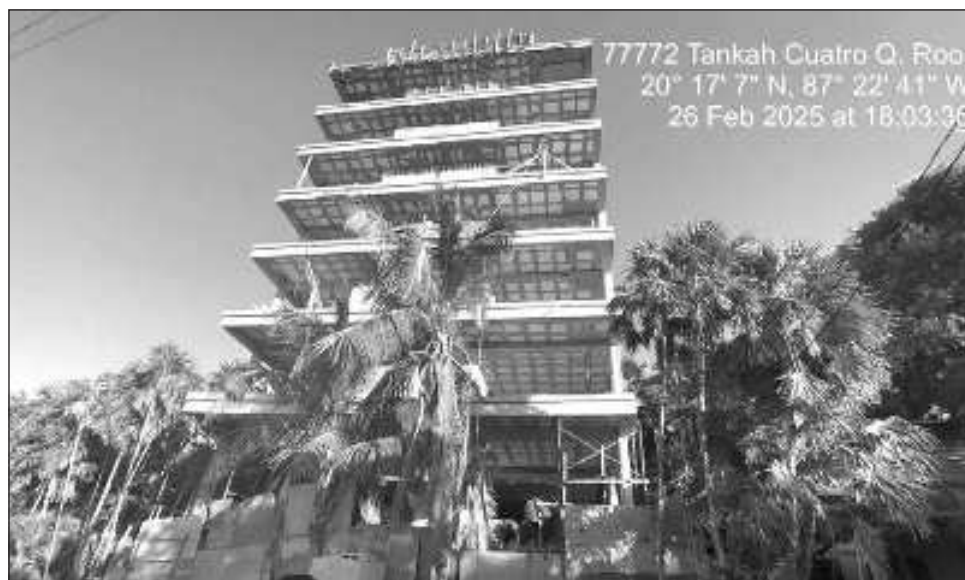
▲ Ambos proyectos fueron clausurados por la Profepa; sin embargo, solicitaron las autorizaciones a la Semarnat, que les fueron negadas y, pese a ello, continuaron construyendo. Foto cortesía DMAS
