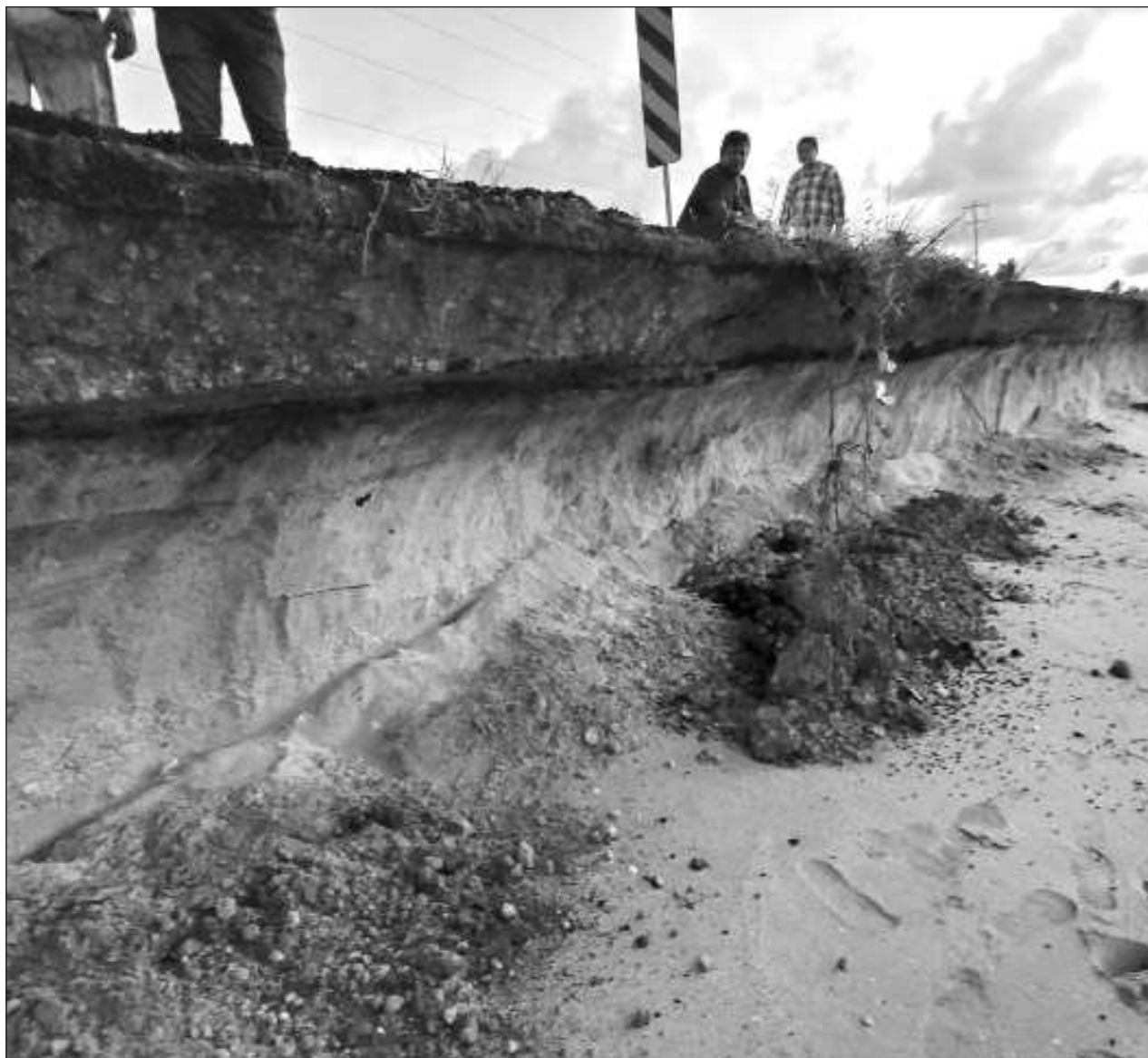
▲ “En esta zona es frecuente que en la temporada de lluvias, las mareas aumenten hasta áreas cercanas a la carretera, ocasionando erosión con el riesgo de ruptura de la cinta asfáltica e interrupción del tránsito vehicular”, subrayó Julio Villanueva Peña. Foto Gabriel Graniel
