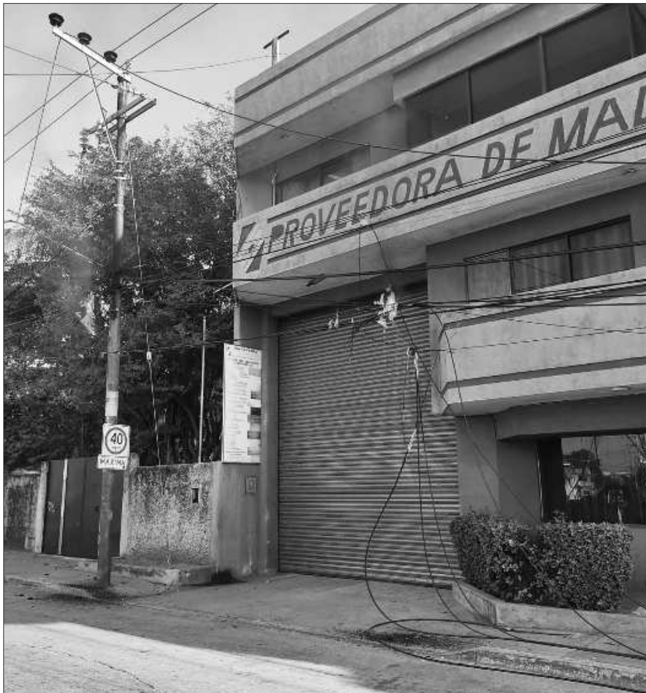
▲ Se presentó un incendio en un transformador de CFE, lo cual afectó el cableado de Telmex. Foto La Jornada Maya
