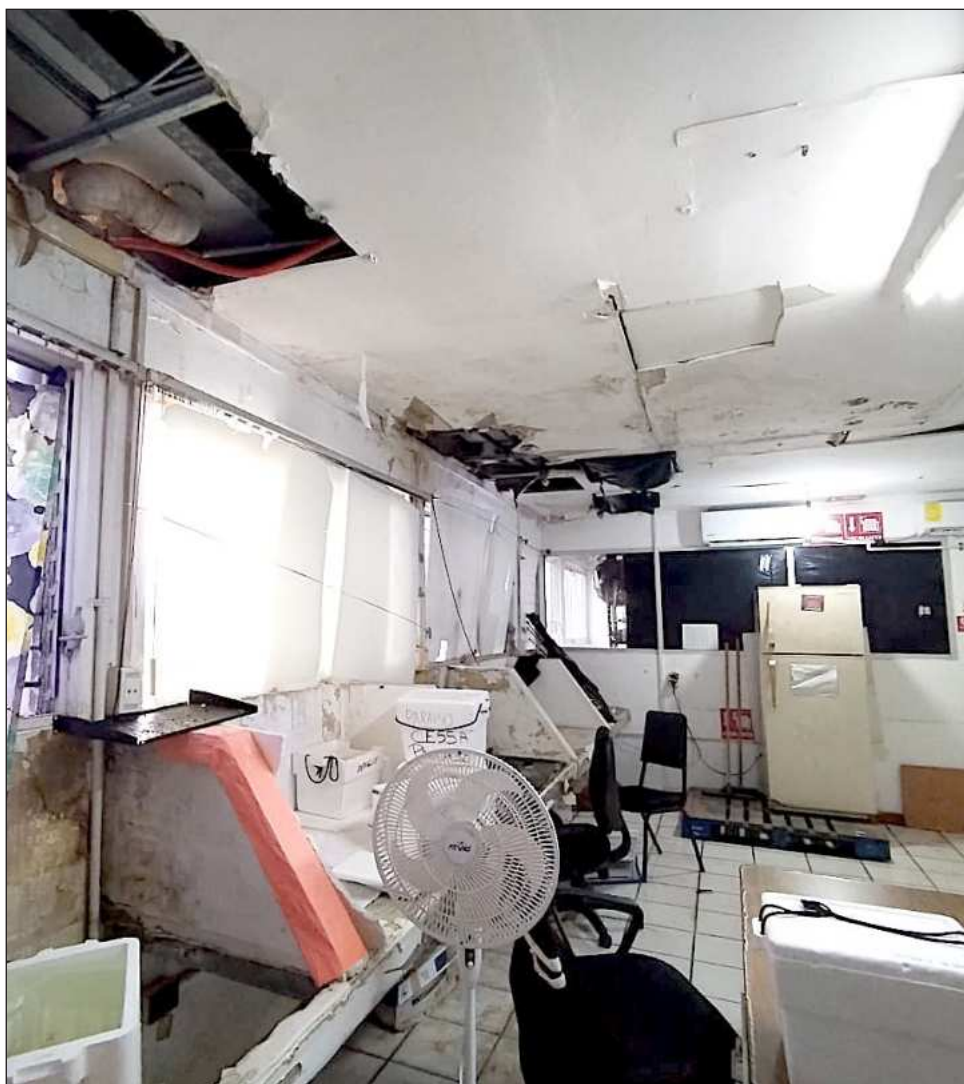
▲ Las recientes lluvias de gran intensidad han revelado la falta de mantenimiento y las condiciones inadecuadas de algunos inmuebles para soportar tanta cantidad de agua. Foto Cortesía
