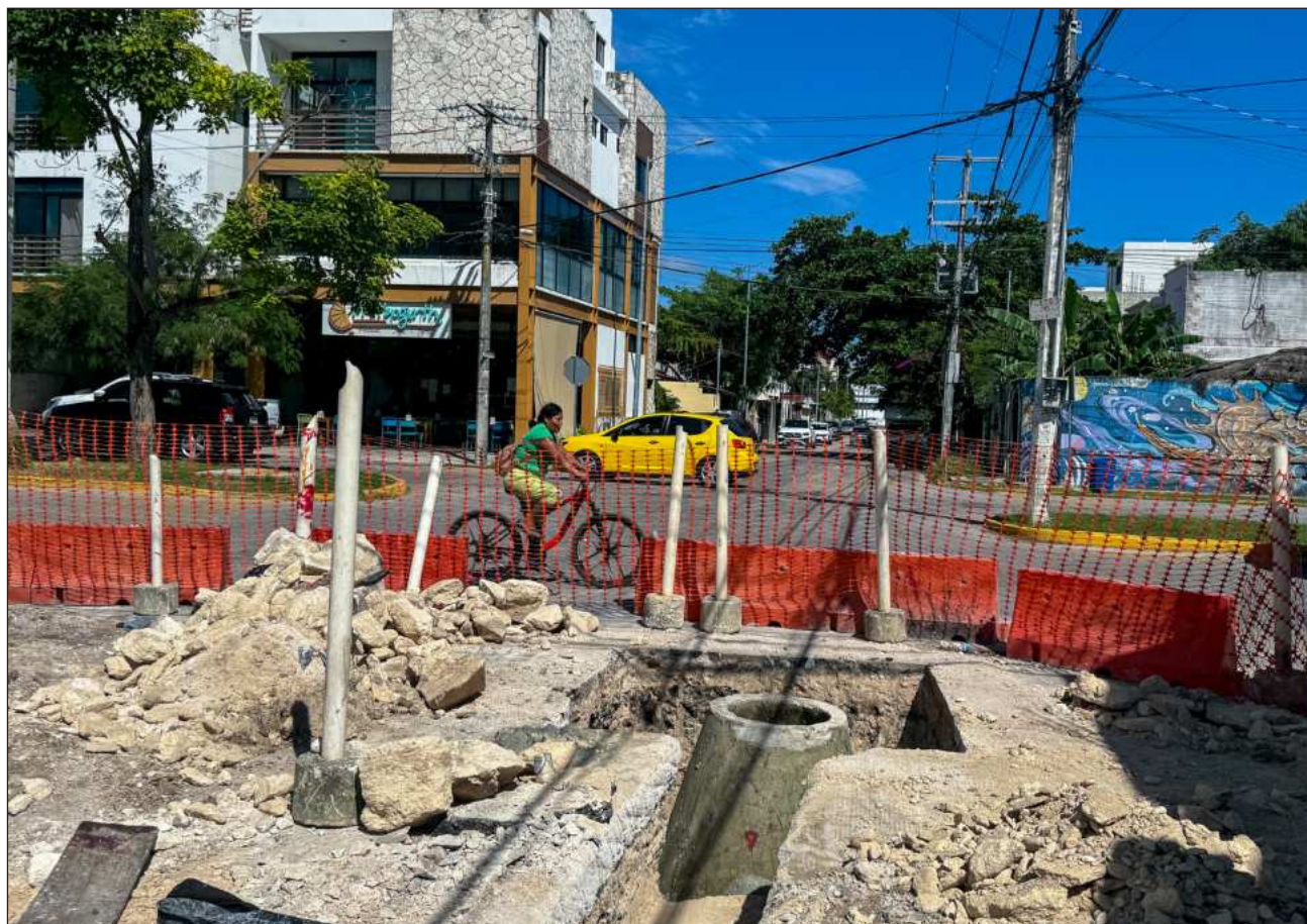
▲ Funcionarios y regidores señalaron durante la reunión a la Comisión Federal de Electricidad (CFE) por su escasa participación en las mesas de coordinación y por los rezagos detectados en infraestructura urbana. Foto Juan Manuel Valdívia
