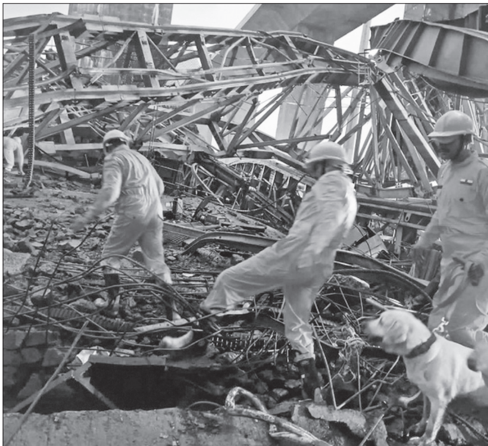
▲ La grúa se desmoronó sobre losas de hormigón, de las cuales se desprendieron fragmentos que mataron a los obreros que trabajaban en la construcción de la autopista Samruddhi. Foto Ap
