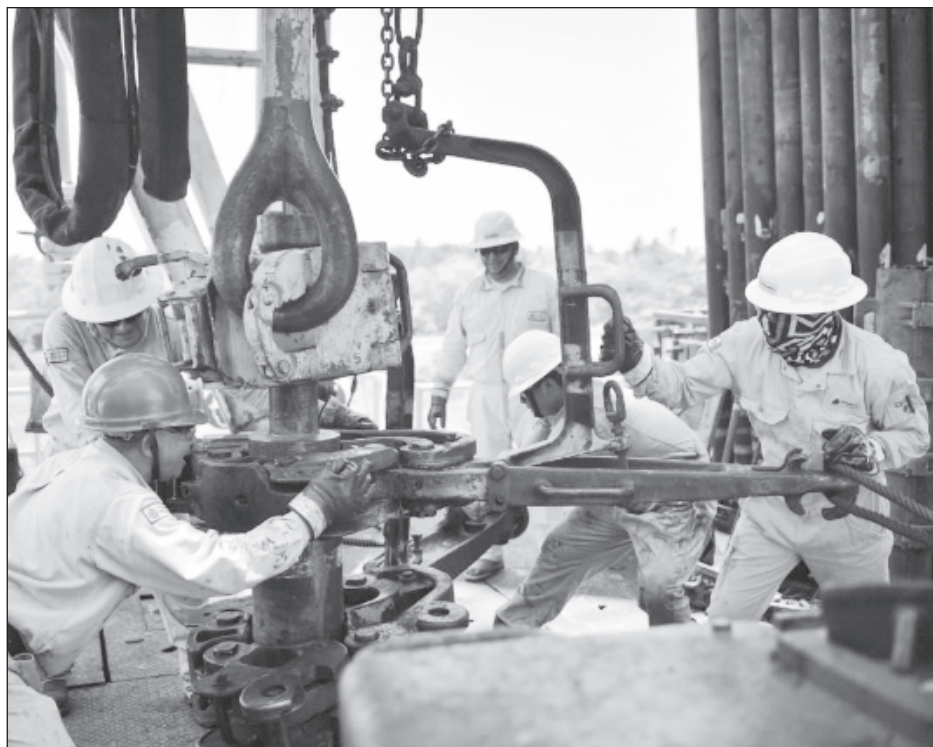
▲ “La red de tuberías de Pemex en la península de Atasta se encuentra toda oxidada y podrida, las cuales pese a encontrarse en subsuelo”: José Manuel May. Foto Twitter @Pemex
