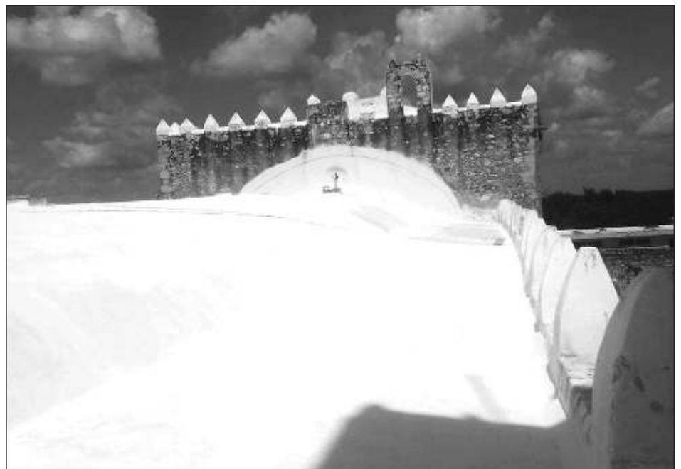
▲ Los feligreses han aplicado impermeabilizante, pero no es suficiente para reparar el techo, por lo que han requerido la ayuda de autoridades estatales y federales. Foto Facebook Parroquia San Luis Obispo
