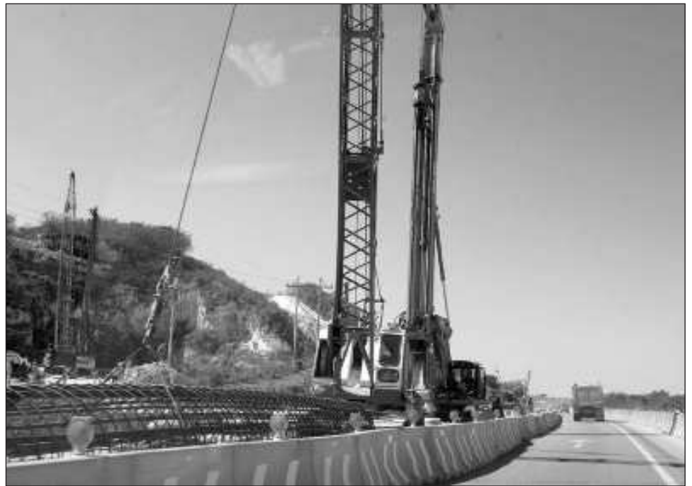
▲ La titular de la Secretaría de Desarrollo Territorial, Urbano y Obras Públicas de Campeche, Isabel Espinoza Segura, afirmó que trabajar en las reparaciones carreteras mientras sigue pasando la maquinaria pesada sería un desperdicio de dinero, pues no duraría mucho tiempo. Foto Fernando Eloy
