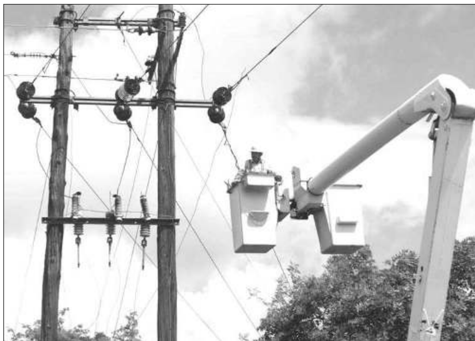
▲ La Japay informó que un desperfecto en un pararrayos provocó afectaciones en la llegada del flujo eléctrico en la planta Mérida I, causando el corte del servicio. Foto Japay
