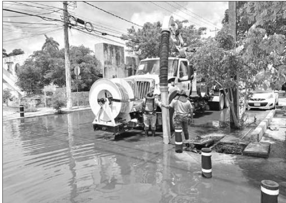
▲ El ayuntamiento ha fortalecido la coordinación con la Dirección de Servicios Públicos en la atención y mantenimiento de toda la infraestructura hidráulica de la ciudad Foto ayuntamiento de Mérida
