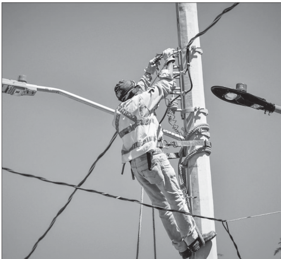
▲ De acuerdo con el director de obras públicas, José Luis Llovera Abreu, se instalaron 31 postes, más 25 luminarias tipo Led, además de mil 792 metros lineales de conductor de aluminio. Foto Facebook Biby Rabelo
