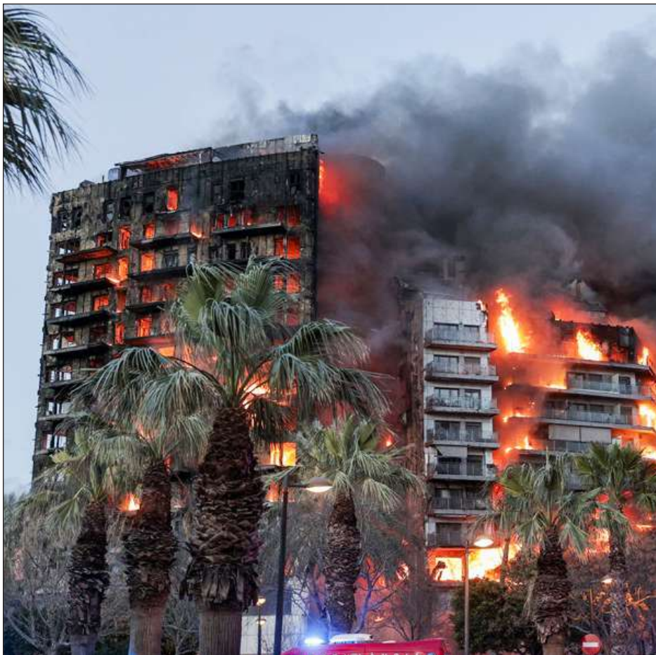
▲ El incendio, que se desató en un quinto piso del inmueble del barrio de Campanar, afectó totalmente al lugar y se propagó a otro edificio que está pegado a él. Foto Efe
