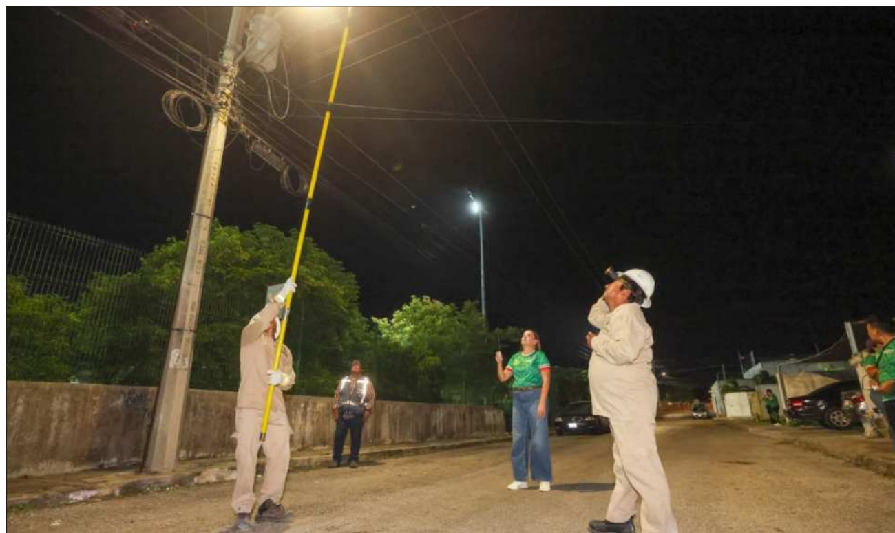
▲ Mérida cuenta con 49 mil 792 luminarias LED, fortaleciendo la cobertura y calidad del servicio de alumbrado. Foto ayuntamiento de Mérida
