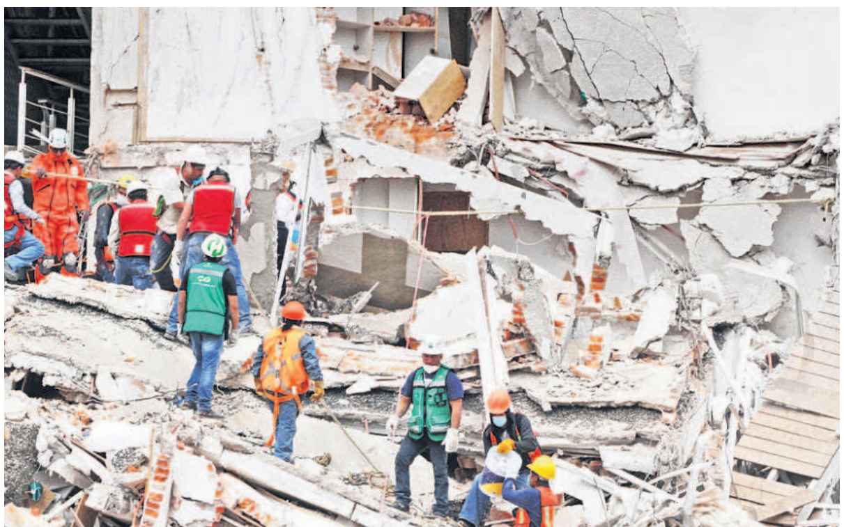
▲ Trabajos de rescate en el edificio ubicado en Zapata y Tlalpan, un día después del sismo de 7.1, 20 de septiembre de 2017. Foto: La Jornada/ Roberto García Ortiz.
