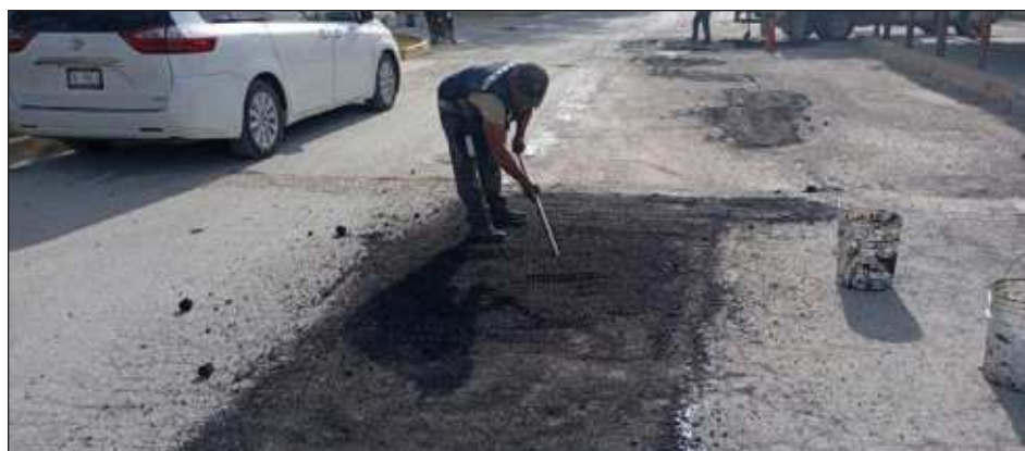
▲ Autoridades piden paciencia ante lluvias que demoran reparación de vías. Foto ayuntamiento de Tulum
