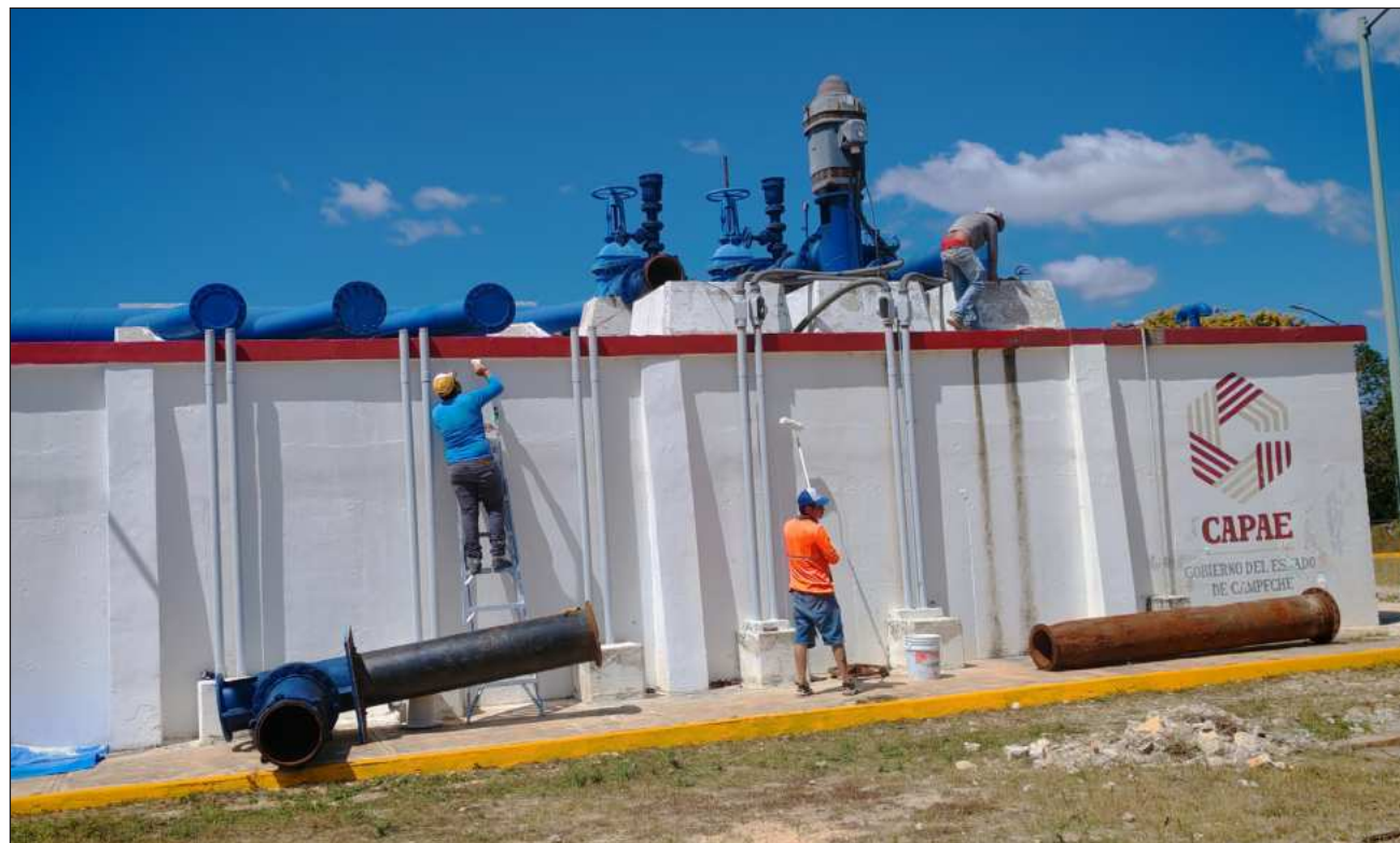
▲ “Al acueducto de Hobomó le falta la alimentación eléctrica para entrar en operación. Los proyectos ya se presentaron por parte de la Comisión Federal de Electricidad”, subrayó Gutiérrez Castro. Foto Fernando Eloy
