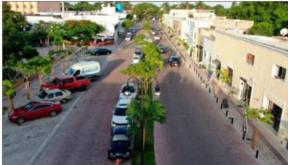
▲ El gobernador Mauricio Vila agradeció el apoyo y la paciencia de los locatarios y vecinos, quienes han respaldado las labores de construcción. Foto gobierno de Yucatán
