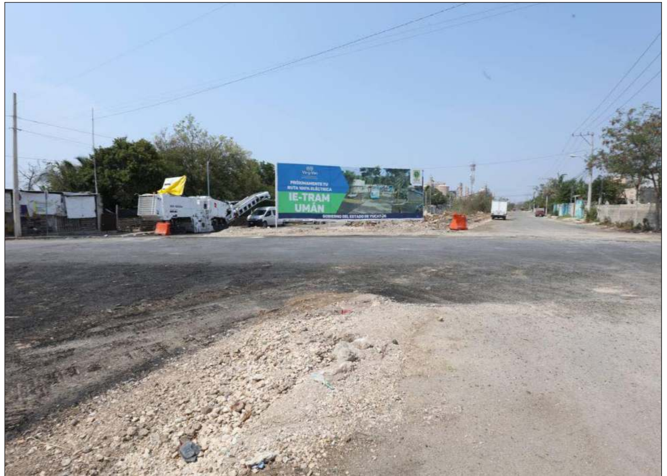
▲ El Instituto de Infraestructura Carretera de Yucatán informó que ya se comenzó esta obra que correrá desde la calle 128 de la colonia Ciudad Industrial hacia el Anillo Periférico, paralela a las antiguas vías del ferrocarril. Foto gobierno de Yucatán
