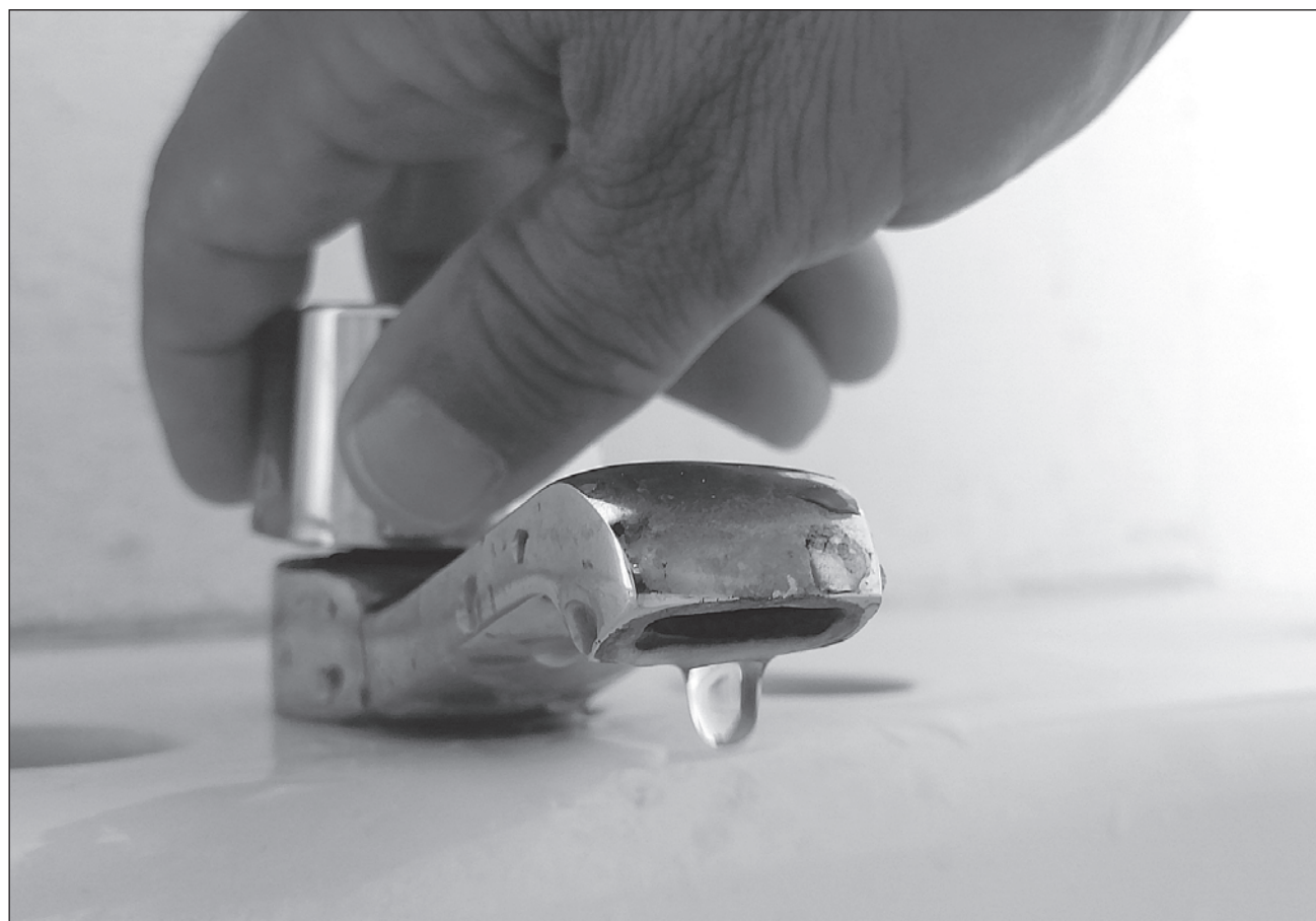
▲ Los acueductos existentes presentan fallas continuas y generan molestia entre carmelitas. Foto Fernando Eloy
