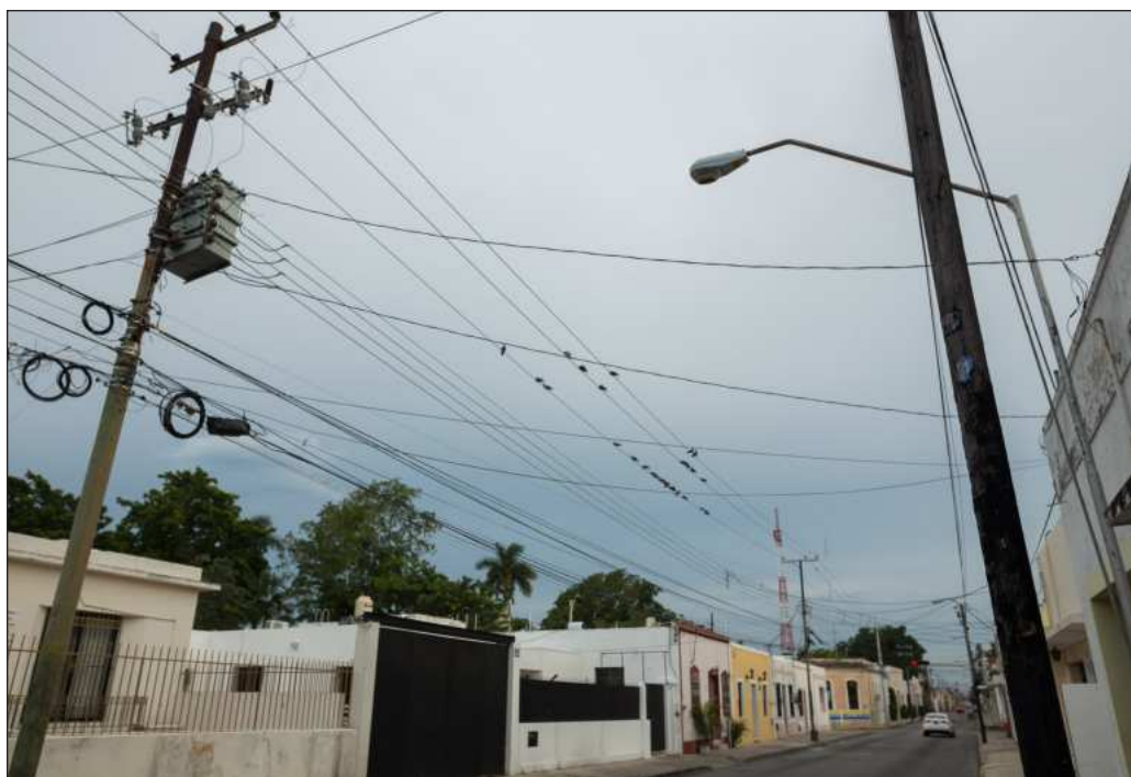
▲ Lo urgente es corregir el rumbo de lo que se ha querido llamar desarrollo, que pretende un crecimiento urbano acelerado para el cual no se tiene la infraestructura de servicios. Foto Enrique Osorno / Archivo
