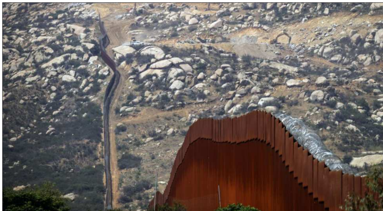
▲ En el poblado de El Manzanito, en las faldas de la montaña del lado mexicano, residentes reportaron haber escuchado explosiones sin previo aviso, antes de identificar la presencia de trabajadores estadounidenses en la zona fronteriza. Foto Efe
