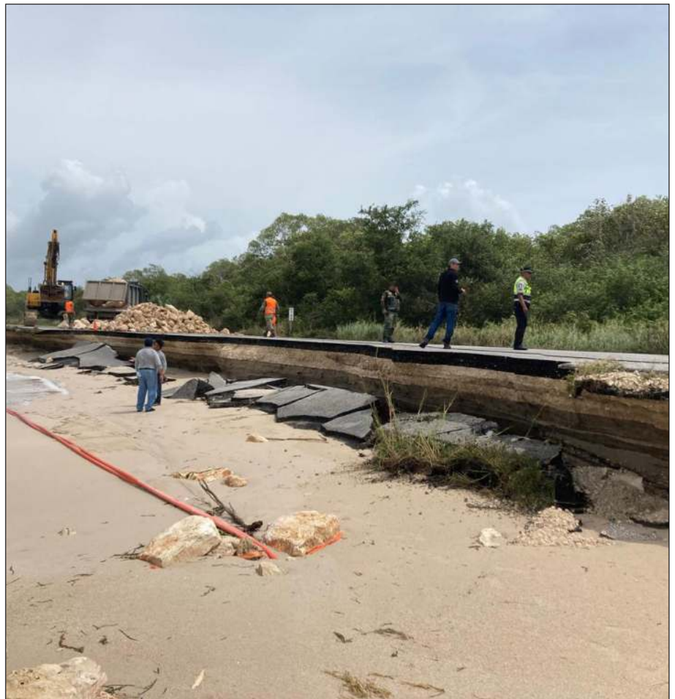
▲ Uno de los daños que se registraron fue un deslave en el kilómetro de 107, de la carretera federal 180, en el tramo Sabancuy-Champotón, por lo que por medida preventiva fue cerrado un carril. Foto @LaydaSansores
