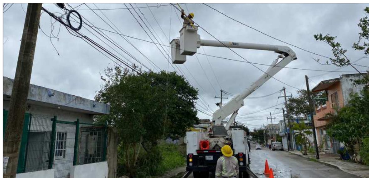
▲ “Los cortes eléctricos son frecuentes en Cholul, donde vivo, porque los transformadores son viejos, los cables aéreos numerosos y caóticos y cualquier ráfaga fuerte (...) causan cortos circuitos e interrupciones”. Foto LJM
