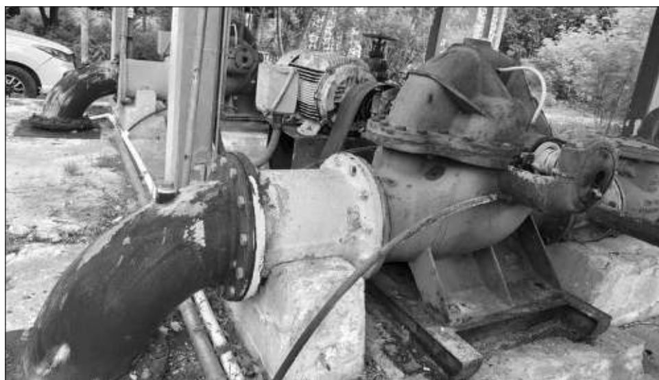
▲ El día 1 de octubre, desde el primer momento, nos dimos la tarea de visitar las zonas de captación y vemos que realmente hace falta mayor inversión en el tema de mantenimiento y conservación de las plantas", puntualizó Francisco Torres Rivas. Foto Japay
