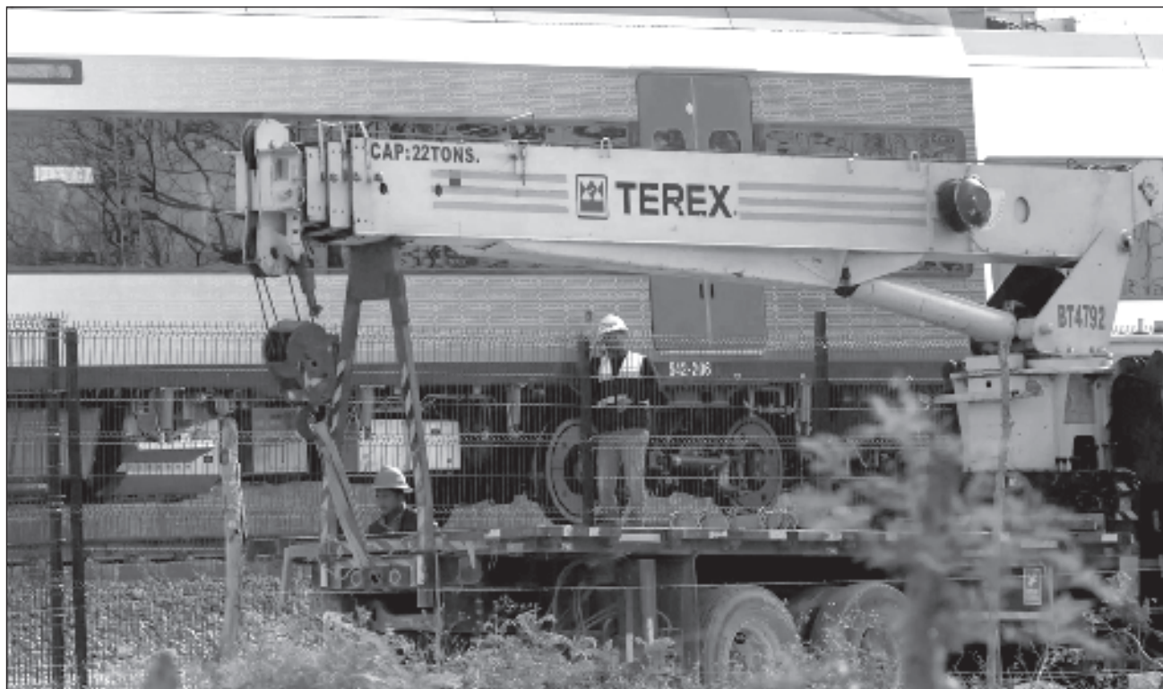
▲ El titular de la Sedena, Luis Crescencio, dio a conocer que sigue la cuantificación de daños: tanto la empresa constructora de ese tramo como la de los trenes participan y se pusieron en marcha los procesos para aplicar el seguro. Foto Efe
