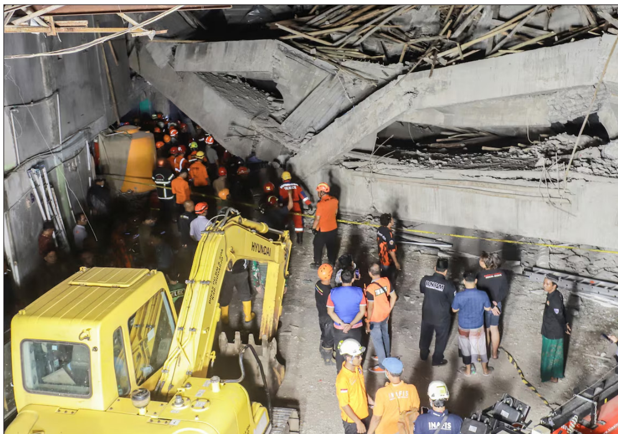
▲ El Consejo Nacional de Reducción y Gestión del Riesgo de Desastres reportó 147 heridos en las islas centrales, donde 22 edificios resultaron dañados. Las labores de rescate se vieron limitadas por las réplicas. Foto Reuters
