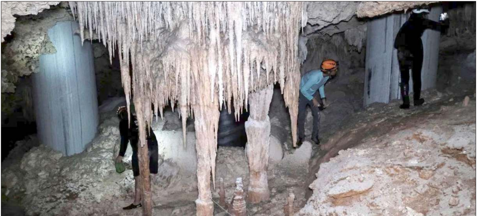
▲ Ante los señalamientos sobre fracturas y perforaciones de cavernas para enterrar las columnas de acero y concreto, el mandatario federal reconoció que sí se ha hecho, pero que los pilotes "van forrados" con una "funda especial" a fin de evitar la contaminación del agua. Foto Reuters
