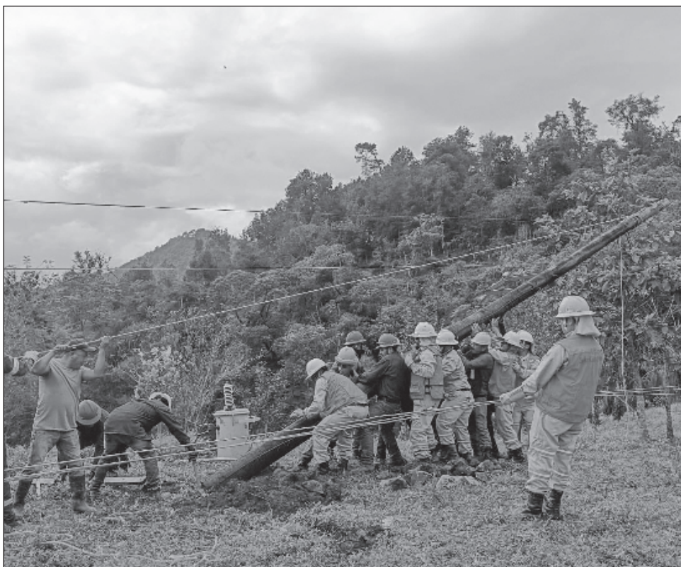
▲ La empresa invertirá 544 millones de pesos en la red nacional de transmisión con el remplazo y la modernización de equipos de las zonas de Juárez y de Torreón. Foto @_CFEmx
