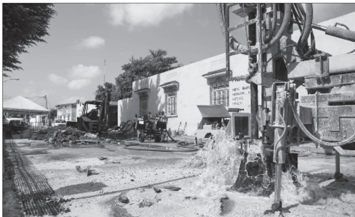
▲ “Se destacó que las interrupciones en el suministro eléctrico afectan el funcionamiento de las bombas de agua, lo que a su vez reduce la presión del agua y disminuye la eficacia del servicio”. Foto Enrique Osorno
