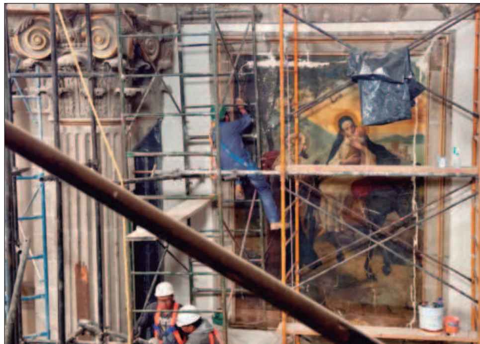
▲ Cinco días después del sismo del 19 de septiembre de 2017, 40 por ciento de la cúpula colapsó. El derrumbe dañó cinco de los ocho vitrales; muros y arcos registraron grietas y fisuras. Foto Roberto García Ortiz
