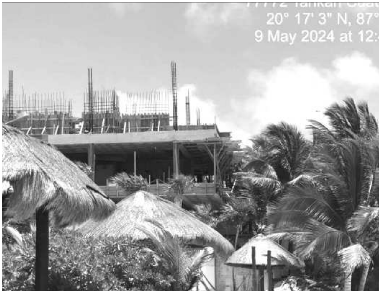
▲ La acción legal es contra un particular, derivado de la construcción de un edificio en una zona de anidación de la tortuga marina en Bahía Solimán, desarrollo que incluso antes ya había quebrantado la ley rompiendo sellos y continuando con la obra. Foto cortesía DMAS
