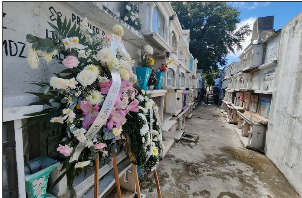
▲ La Dirección de Proximidad y Protección Civil también ha iniciado las verificaciones en los cementerios para identificar posibles áreas que representen algún riesgo o vulnerabilidad. Foto Fernando Eloy
