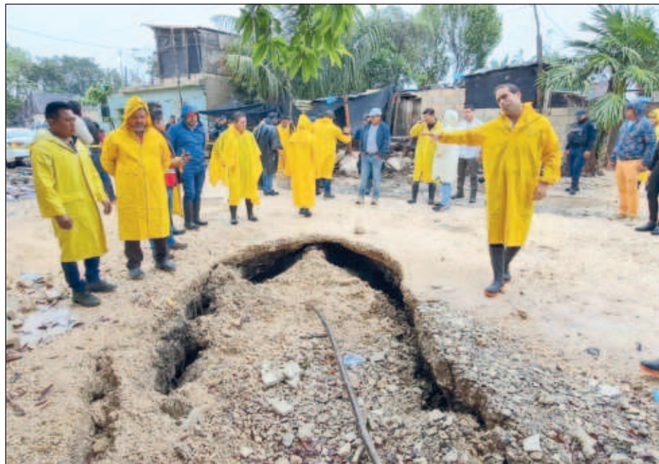
▲ Diego Castañón recorrió la zona donde se registró un socavón en la colonia irregular 2 de Octubre, el cual –aseguró el alcalde– será reparado lo antes posible. Foto Miguel Améndola
