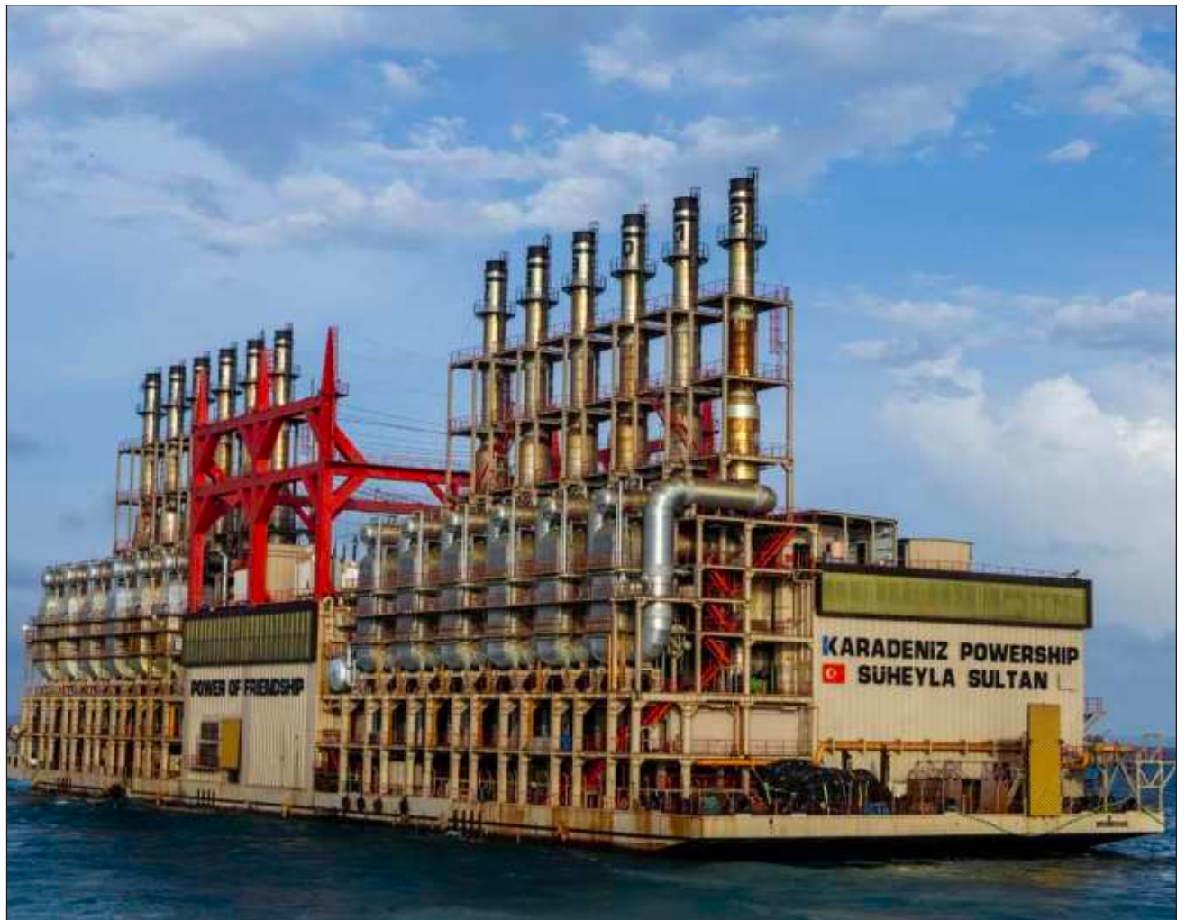
▲ El Karadeniz Powership tiene una turbina que convierte la energía calorífica que producen sus 12 generadores en más electricidad, con una capacidad óptima del 47 al 50 por ciento en comparación con las menores eficiencias de las plantas en tierra firme. Foto Cortesía
