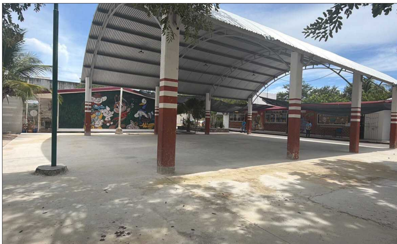
▲ PC estableció coordinación con el Colegio de Ingenieros y Arquitectos de Tulum para realizar una evaluación técnica que determine si existe alguna cavidad, socavón, hundimiento u otra condición que pudiera representar un riesgo. Foto Miguel Améndola
