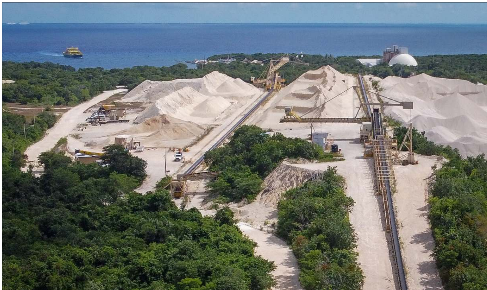
▲ De 2016 hasta abril de 2022 se observó que la extracción de material pétreo por debajo del nivel freático ha provocado el crecimiento de cuerpos de agua en los predios de Calica, impactando directamente los sistemas subterráneos acuáticos y al menos se destruyeron tres cenotes dentro del predio en cuestión. Foto Juan Manuel Valdivia
